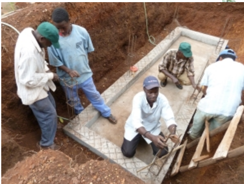
Foto: Bau der Biogasanlage – Lokale Arbeiter werden ausgebildet, um später selbstständig weitere Anlagen bauen zu können
