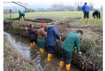
(2) Anlage Weidenflechtwerk (Twiesbach)
